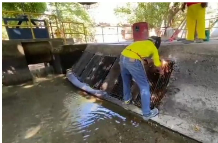
Reparación de infraestructura – Zona de bocatoma en la Planta de Tratamiento de Agua Potable
